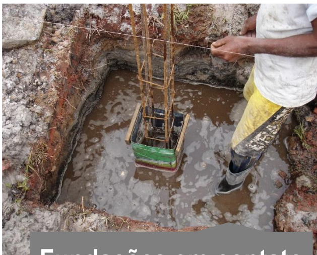
Fundações em contato com água
