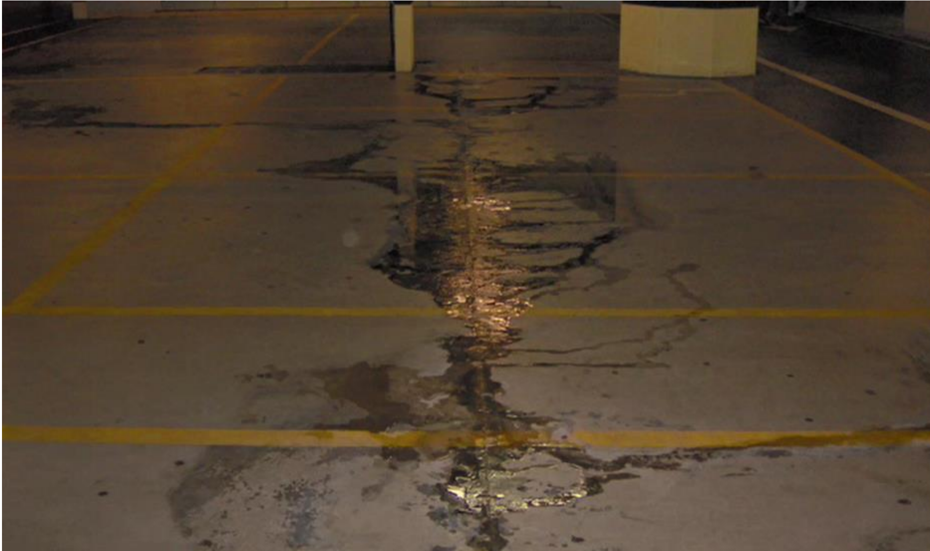
Detalhe da junta fria/junta de concretagem que apresentava infiltração
